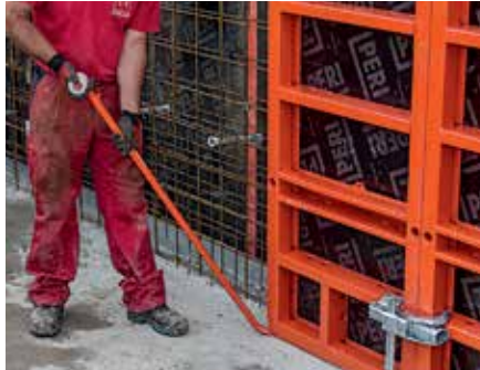
Az emelősarkok lehetővé teszik az elemek kalapács nélküli mozgatását. Különösen egyszerűen kivitelezhető ez a kizsaluzó kar segítségével.
