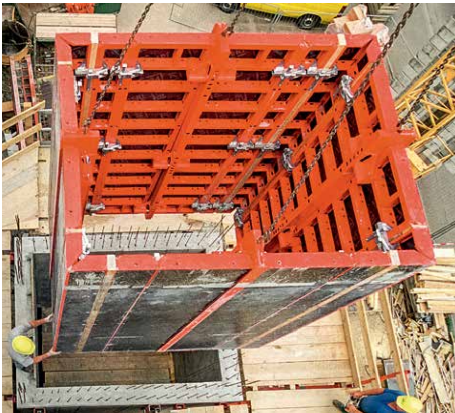
Téglalap alakú aknák esetén a különböző oldalhosszak miatt a darukötelek szárait különböző hosszúságúra kell állítani oly módon, hogy emeléskor az egyes szarak közel azonos mértékben legyenek terhelve.
